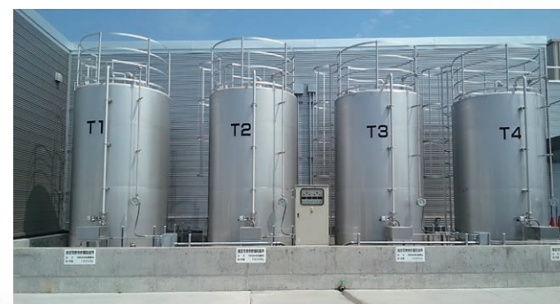
新油タンク 4台
