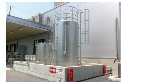
新油タンク + 廃油タンク
